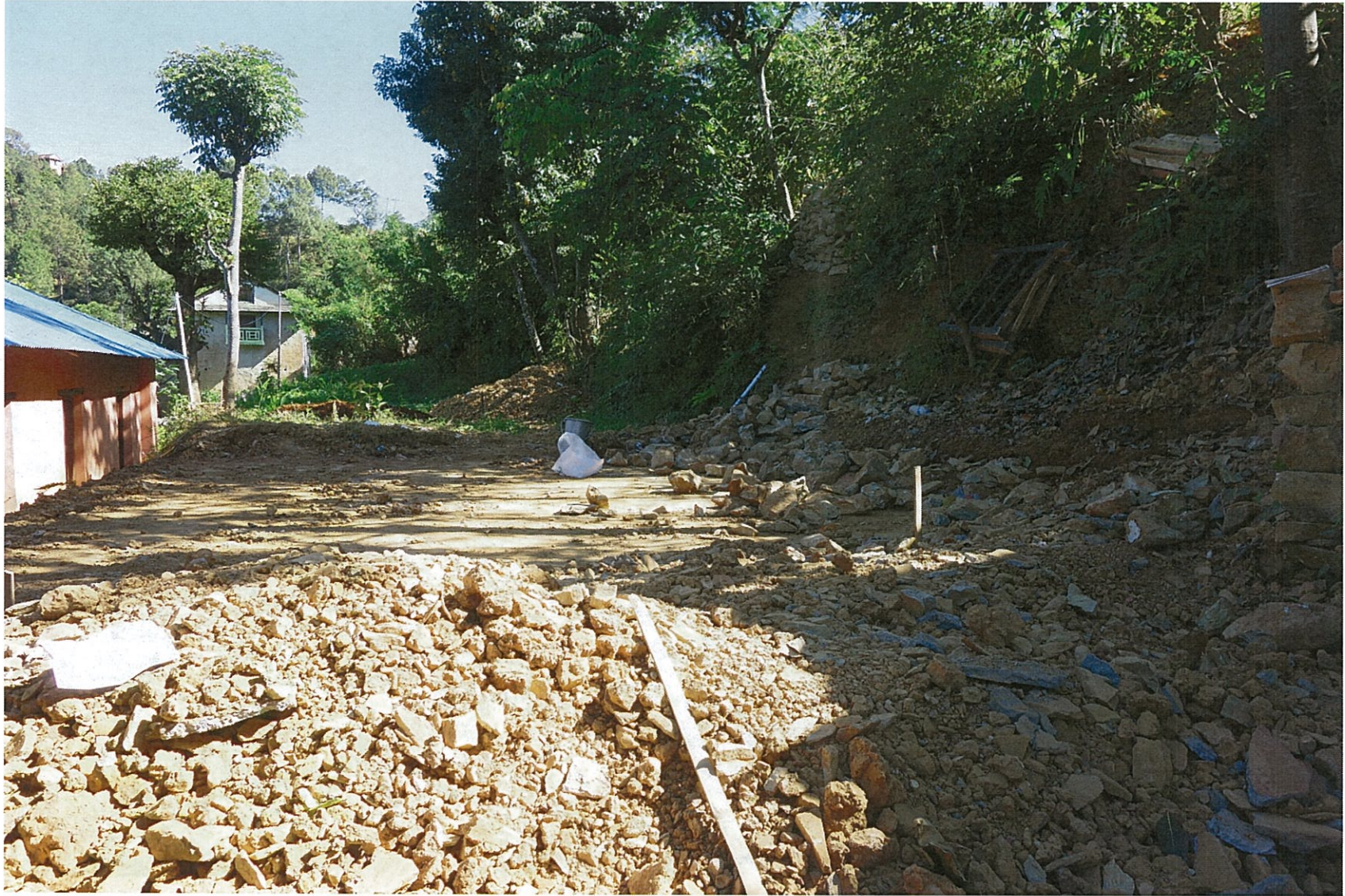
地震で全壊した以前の寺子屋の建物
